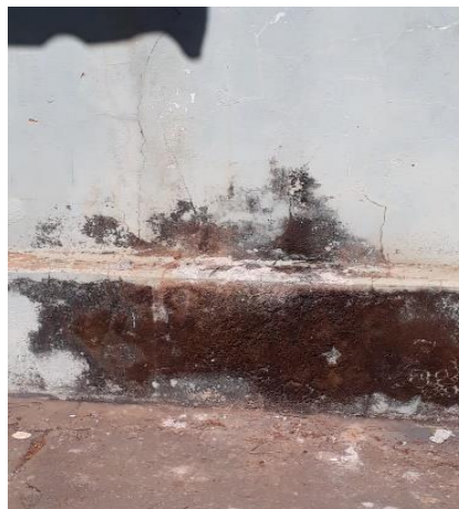
Figura 8 - Marcas da água na parede
