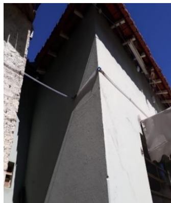
Figura 21 - Imagem do sistema no segundo pavilhão
