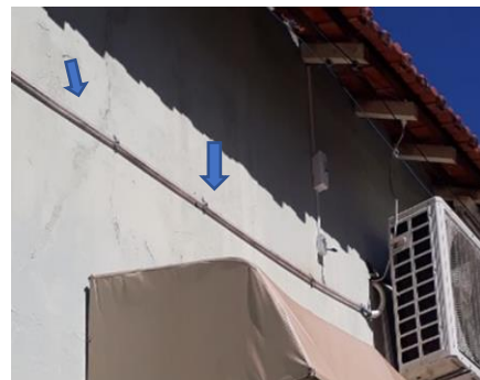
Figura 12 - Sistema de captação ligado ao ar condicionado
