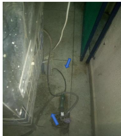
Figura 7 - Mangueira de descarte da água
