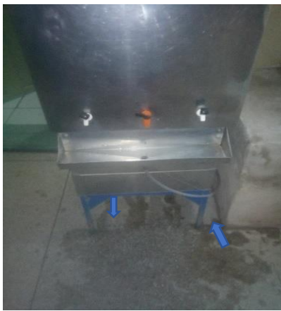
Figura 6 - Água derramada no chão
